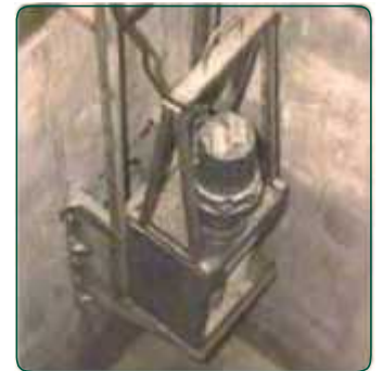
Channel Monster ugrađen u crpnoj stanici sa okvirom i vodicama.
